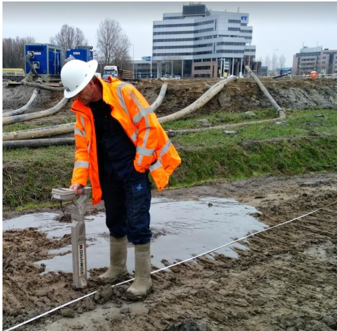
Blow-out op het maaiveld
